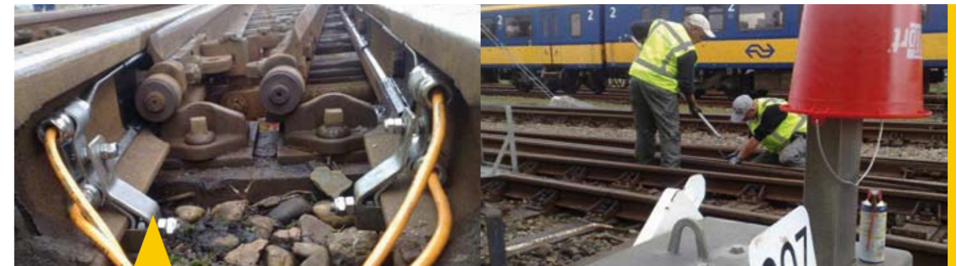
Van Gelder Rail legt langs de spoorstaven een verwarmingselement, dat moet voorkomen dat de sporen bevroren.
